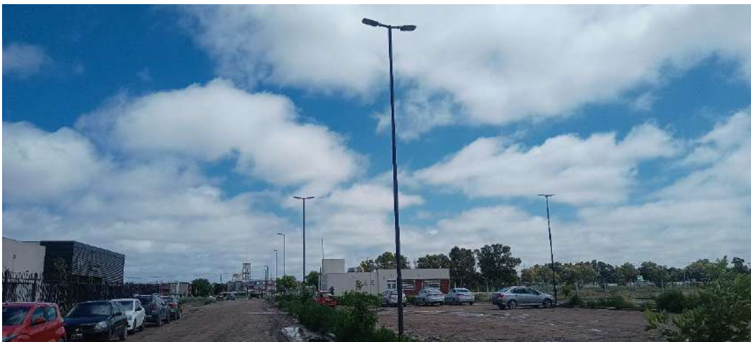
Imagen. Iluminación Acceso al Hospital Escuela de Kinesiología.
